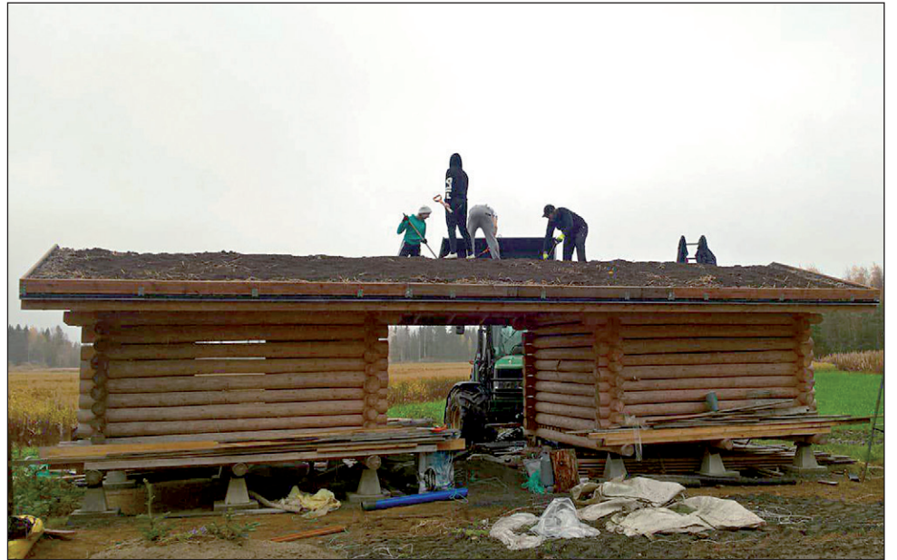
Viime viikonloppuna Hannuksen oman pariladon päälle rakennettiin erikoislaatuista viherkattoa. Tässä on meneillään kasvukerroksen levitys katolle.
