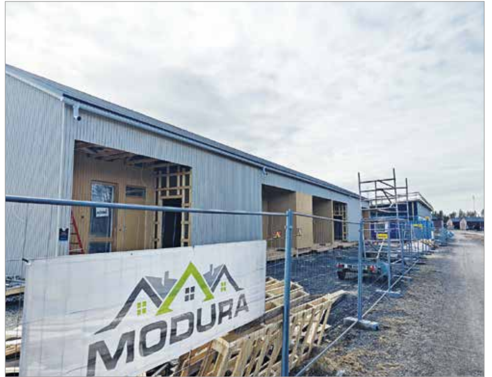
Modura Oy on urakoinut Hiukkavaaran uudella asuinalueella, minne on valmistunut viiden rivitalon kokonaisuus ja lisää on rakenteilla.
