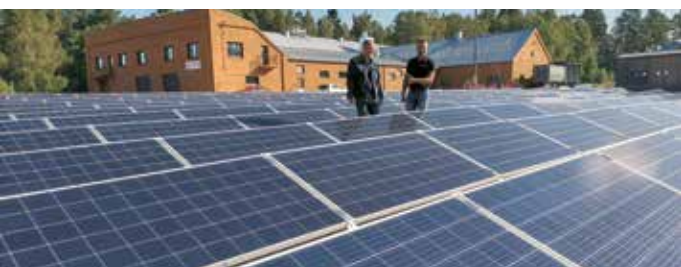
Orapac har egen solenergianläggning vid fabriken och allt spillmaterial återbrukas.
